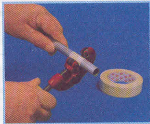
Отрезать трубки в размер удобно с помощью трубореза. Чтобы не повредить поверхность, трубу необходимо предварительно обернуть клейкой лентой.
